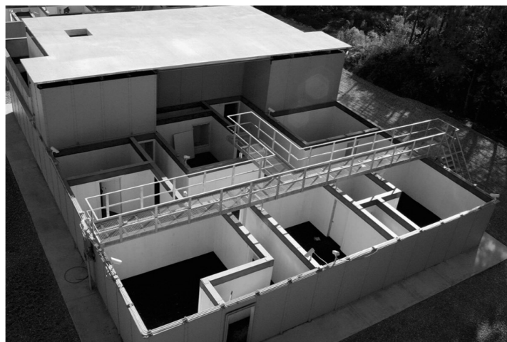
Рис. 2. Тактический тир, построенный с использованием стальных бронепанелей
